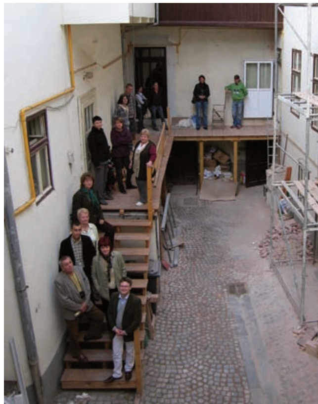
Baustelle Stadtpfarrhaus mit Mitarbeitern der Kirchengemeinde. Durch den neugebauten äusseren Umlauf können sie nun konzentrierter arbeiten, weil ihre Büros keine Durchgangsräume mehr sind.
